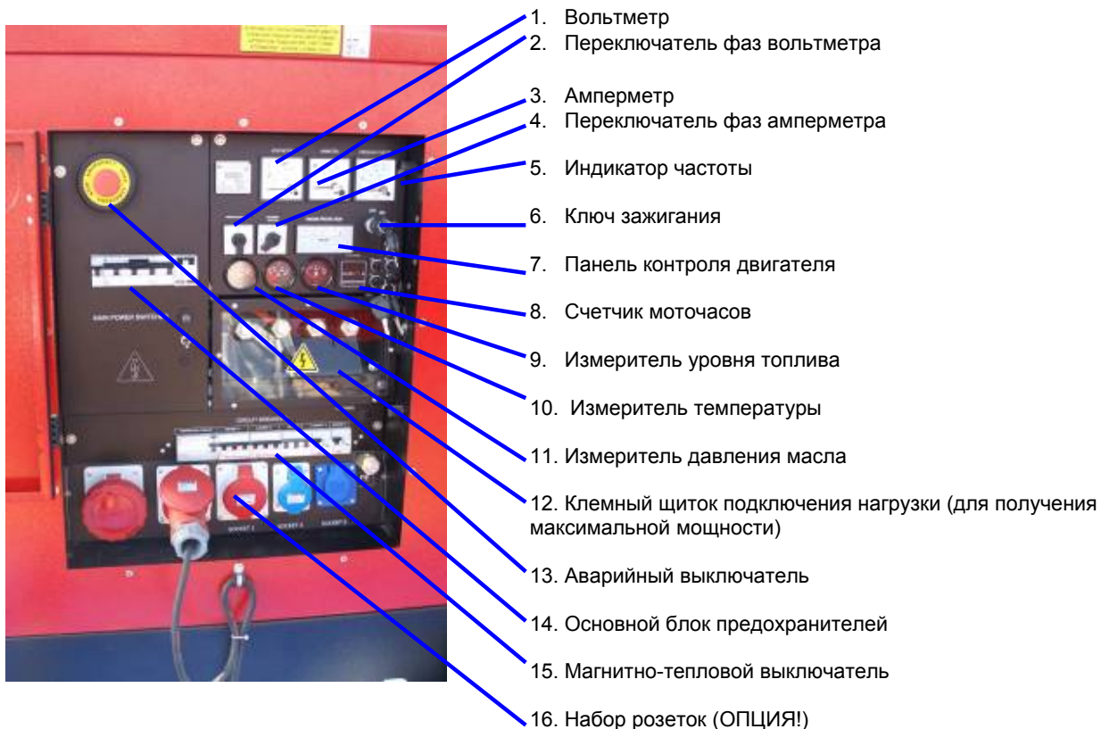
РИС.3 – Общая контрольно-коммутационная панель электростанции типа MS.
