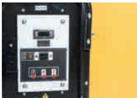
Автоматический контроль горения. Панель управления позволяет задать цифровые параметры
